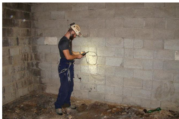
Slika 29. Kuća, Dragišići, pregled pukotina (Foto: G. Rnjak)
