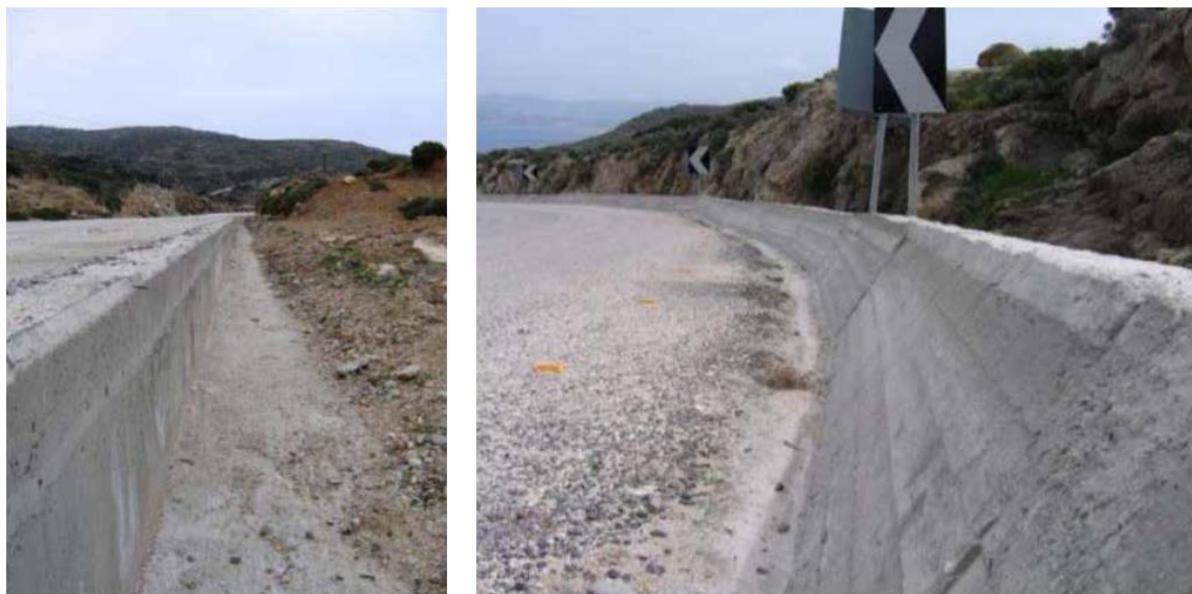
Slika 4.1.8.-1. Primjer betonskih prepreka (Izvor: HAOP 2016)
