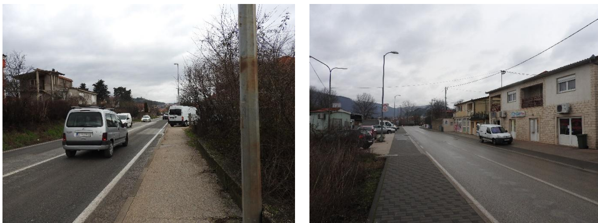
Fotografija C-45: Postojeća rasvjeta na Ul. Bana Jelačića (lijevo) i na Ul. Domovinskog rata (desno) Izvor: Obilazak terena
