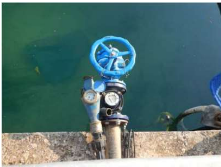
Fotografija D-4: Ugrađeni vodomjeri
