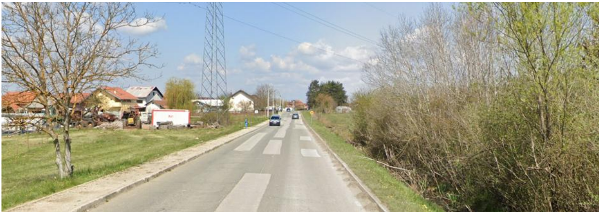
Fotografija A-5: Stanje kolnika na ŽC3200 (pogled u smjeru Siska)
