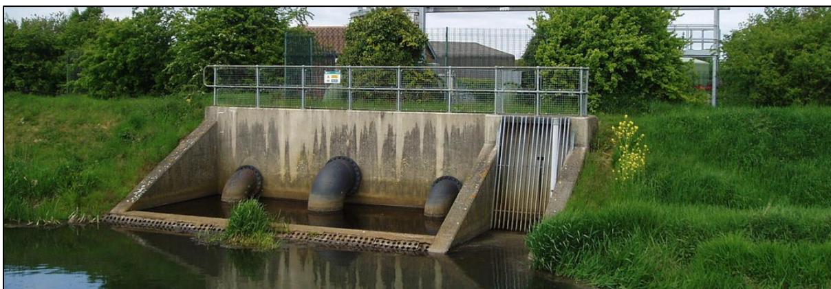
Slika 14. Primjer crpne stanice
