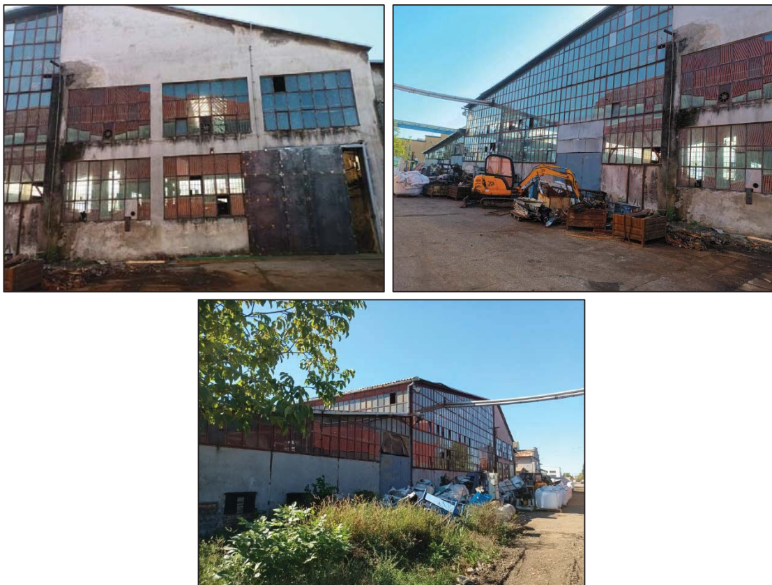
Slika 5. Sjeverno pročelje postojeće zgrade - hale (izvor: Snimak izvedenog stanja za prenamjenu hale u skladište neopasnog otpada od metala, GX-PROJEKTI j.d.o.o., lipanj 2025.)
