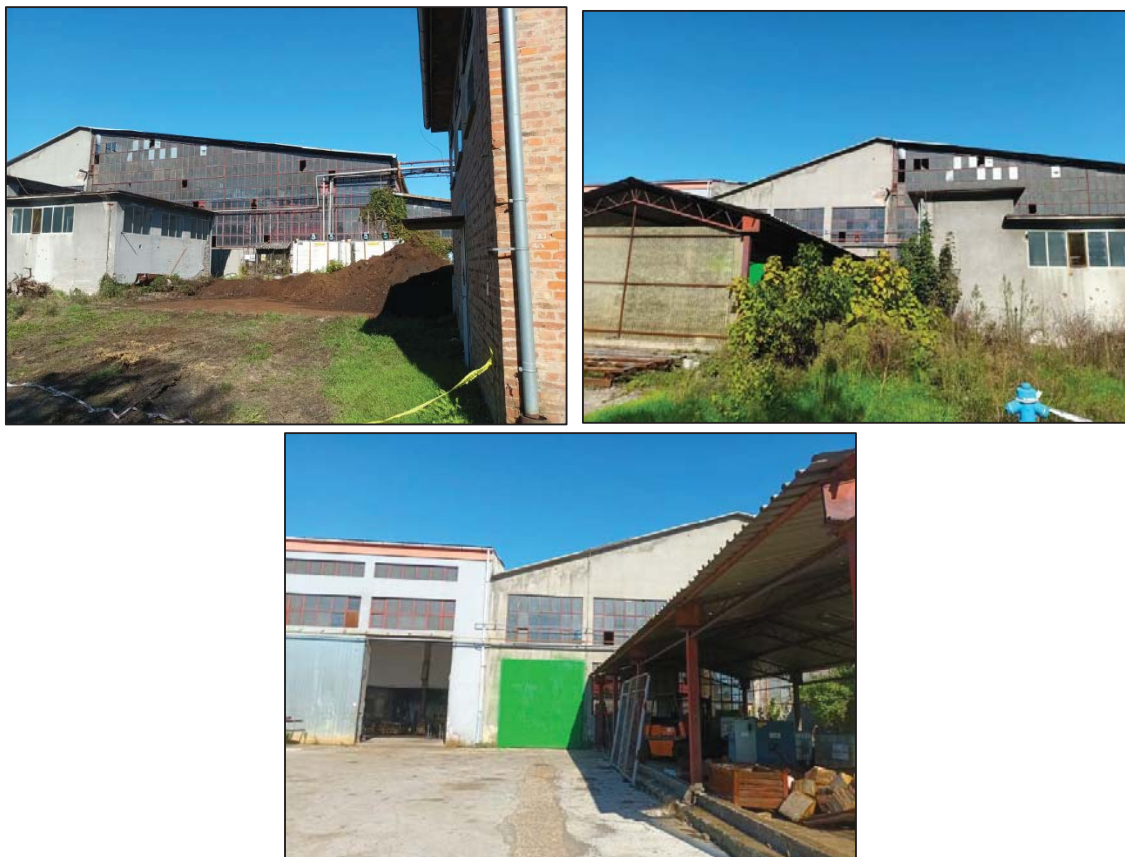
Slika 7. Južno pročelje postojeće zgrade - hale (izvor: Snimak izvedenog stanja za prenamjenu hale u skladište neopasnog otpada od metala, GX-PROJEKTI j.d.o.o., lipanj 2025.)
