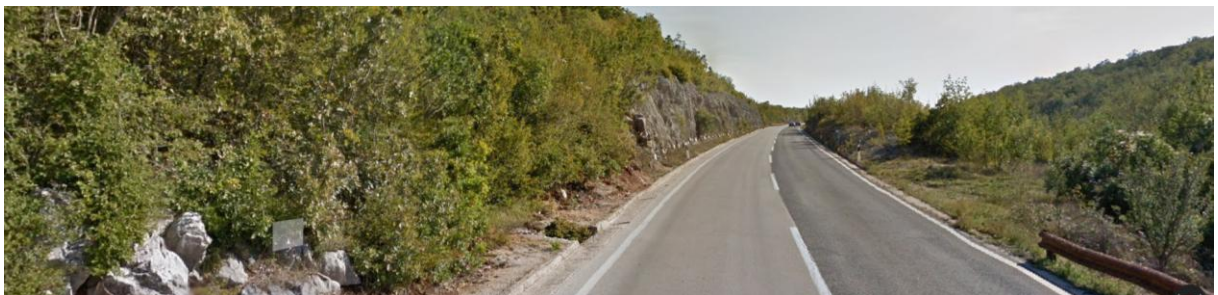
Fotografija 1- 3 Postojeće stanje odvodnje
