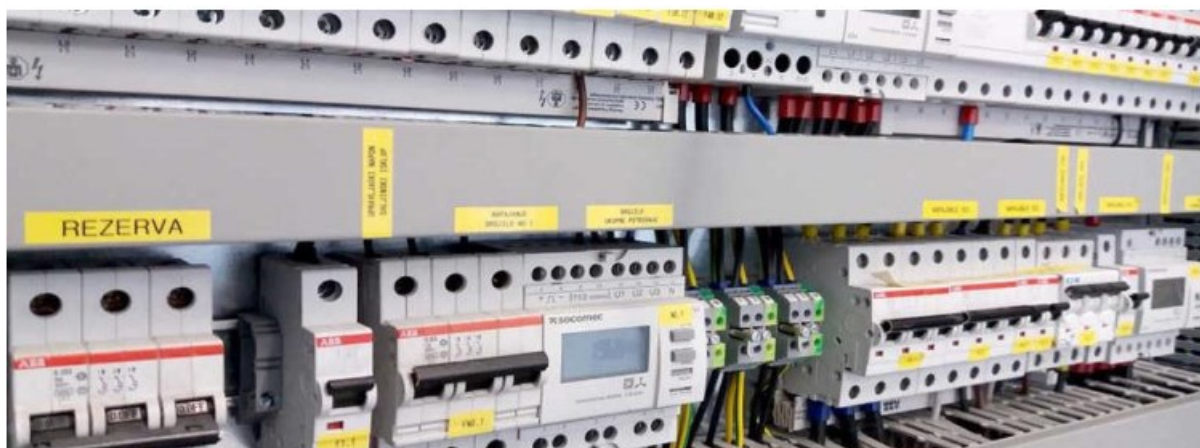
Slika 8. Razvodni ormar – detalj
