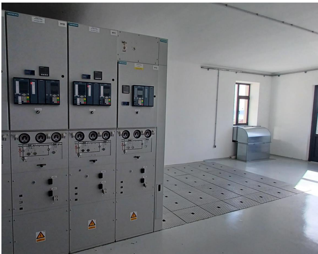
Slika 2.3-3 SN rasklopište u TS 110/35 kV INA RNR
