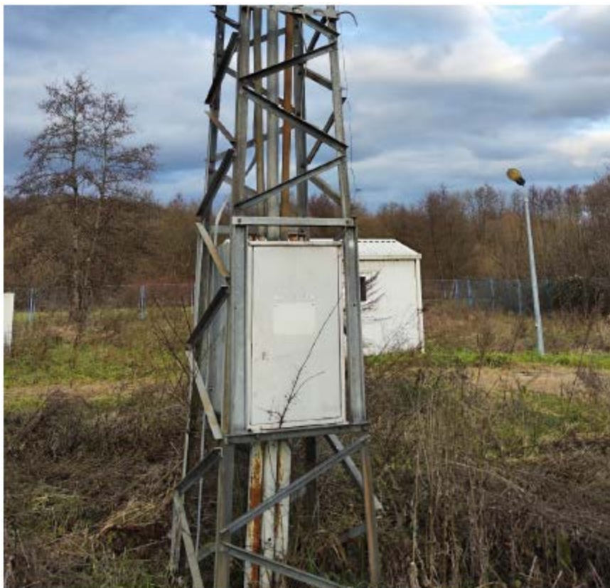
Slika 8. Prikaz postojećeg samostojećeg priključno-mjernog ormara (SPMO) u kojem se nalazi obračunsko mjerno mjesto (OMM) lokacije
