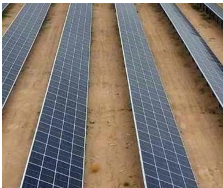
Slika 34. Primjer izvedbe fotonaponskih panela na nosivoj potkonstrukciji pod 26 ° (Izvor: Idejno rješenje – Fotonaponski sustav – Sunčana elektrana Poljana Vojnička, Ured ovlaštenog inženjera elektrotehnike Ivana Medač, dipl.ing.el., siječanj 2024.)
