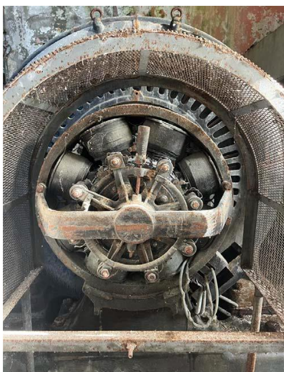
Slika 1. 1 - 5 Postojeće stanje u strojarnici mHE „Vrilo 1“ – generator (izvor: idejno rješenje)
