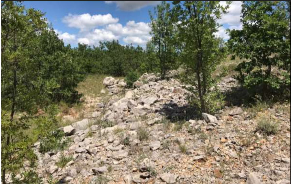
Slika 2.1.2.-10. LOKACIJA 6. I dalje vidljiv iskopni materijal od gradnje autoceste, sjeverna granica deponije
