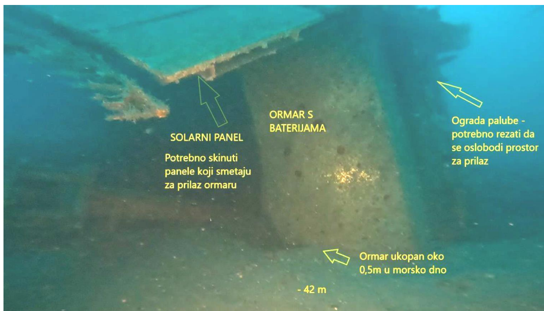
Slika 2.3-6. Prikaz ormar s baterijama na morskom dnu
