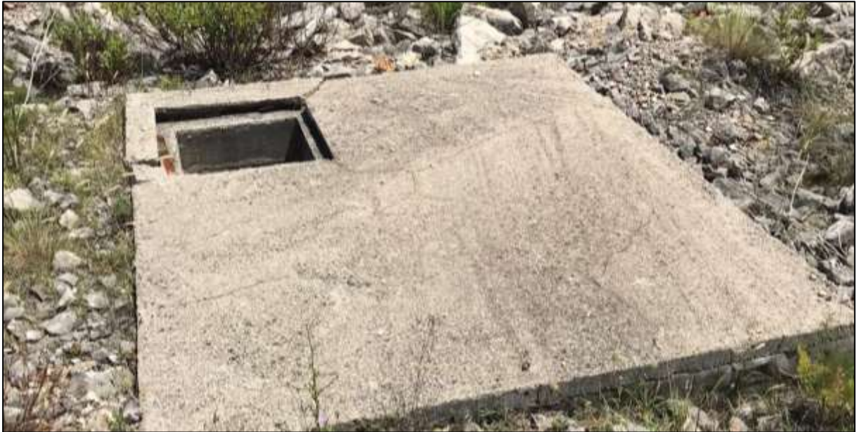
Slika 2.1.-9. LOKACIJA 6. Uz makadamsku prometnicu koja prelazi preko deponije, nalazi se betonski plato sa šahtom unutar kojeg se nalazi ventil vodoopskrbnog cjevovoda.
