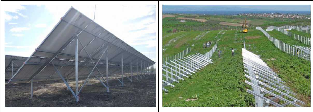
Slika 8. Tipični detalj montaže na zemljanoj površini bez temeljenja, Izvor: Idejno rješenje: Solarna elektrana Sveti Ivan Žabno, ZOP 2128-CD; Broj projekta: 2128-CD-EE-21389, Izrađivač: IVICOM Consulting d.o.o., Zagreb, ožujak 2022.
