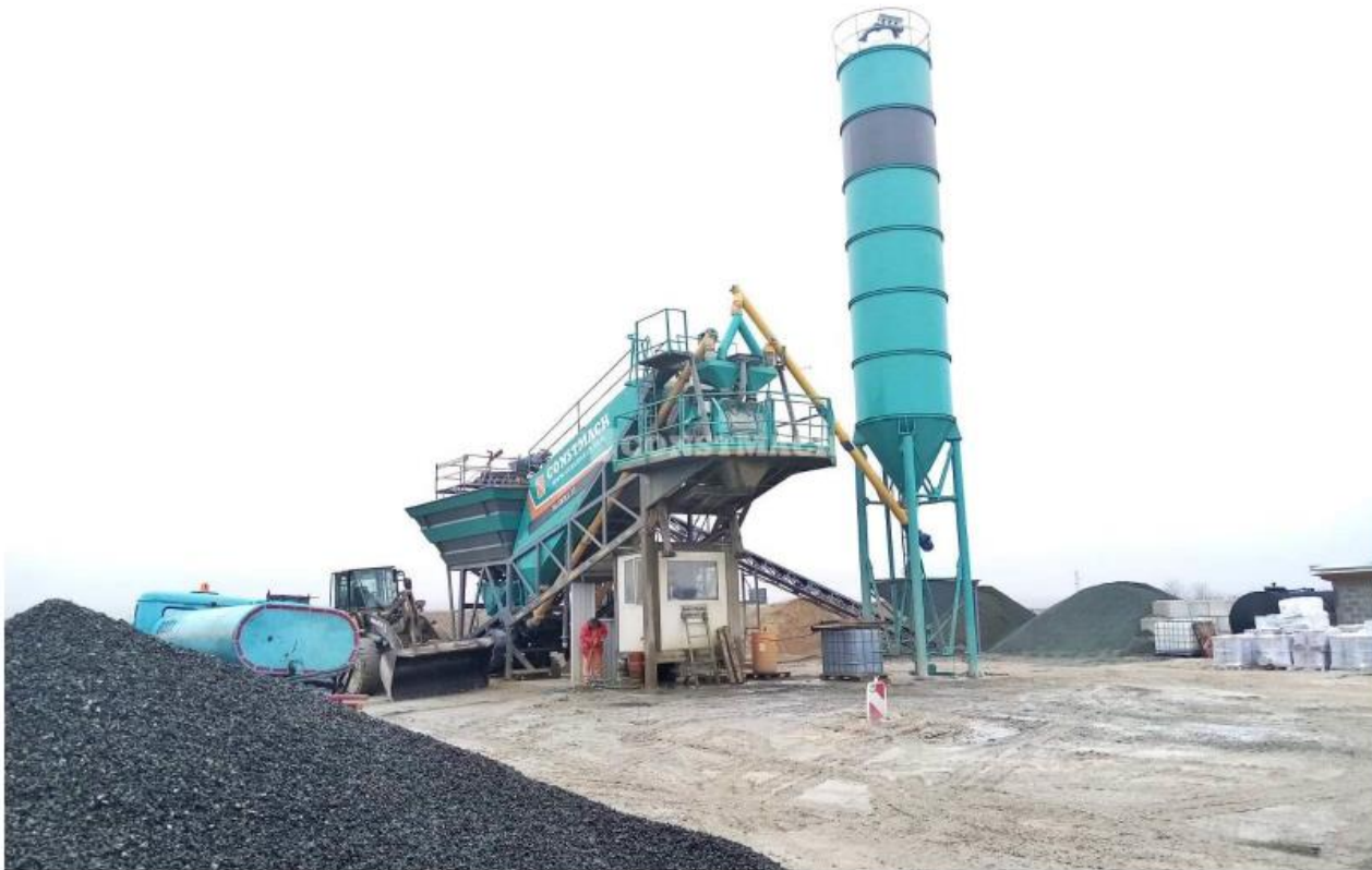
Slika 2.2 Betonara instalirana na terenu (Izvor: Idejno rješenje)
