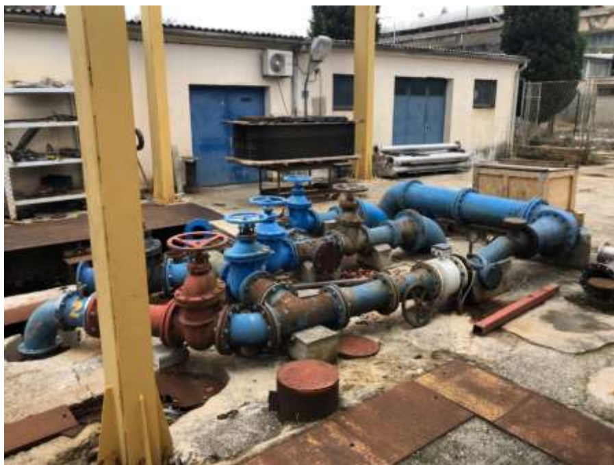
Sustav za crpljenje podzemne vode
