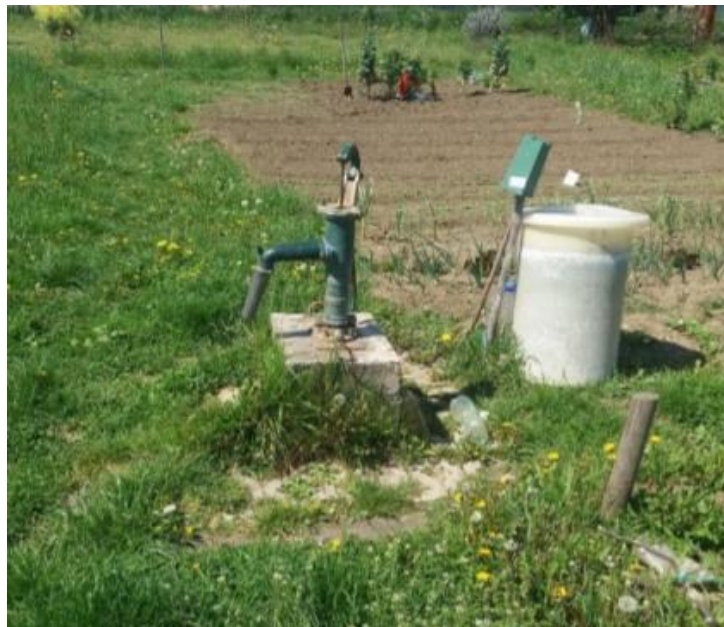
Fotografija 3-1: Zdenac Z1 s ugrađenom ručnom pumpom
