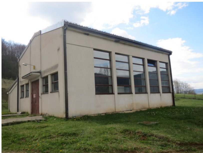
Slika 1. Postojeća crpna stanica
