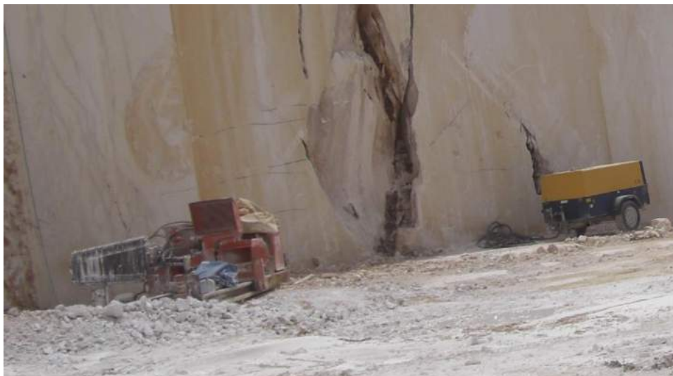
Slika 1.3./5. Lančana sjekačica i diesel agregat [33]
