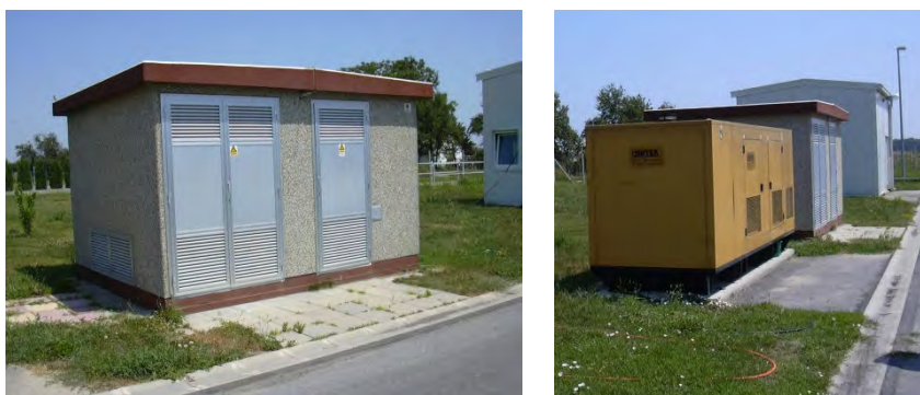
Slika 14. Trafostanica i agregat
