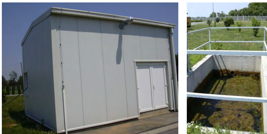
Slika 12. Hidroforsko postrojenje sa sustavom za pročišćavanje (preradu) vode i taložnica
