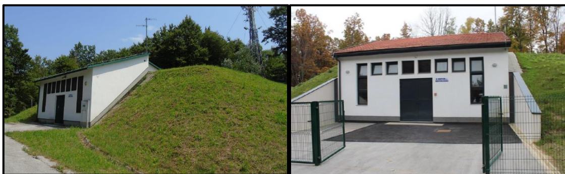
Slika 2.1-3. Vodospremnik Kravarsko (a) i vodospremnik Dubranec (b) (preuzeto iz Hidroprojekt-ing i dr., 2017.)
