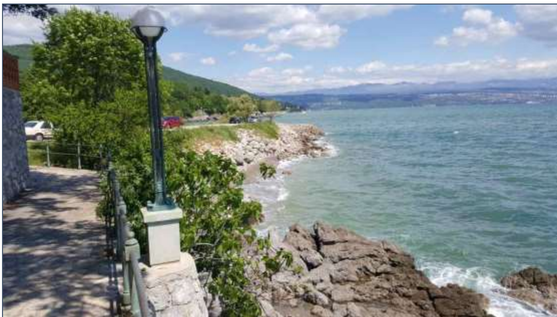
2a. Posljedice korozije i bioerozije vapnenaca
