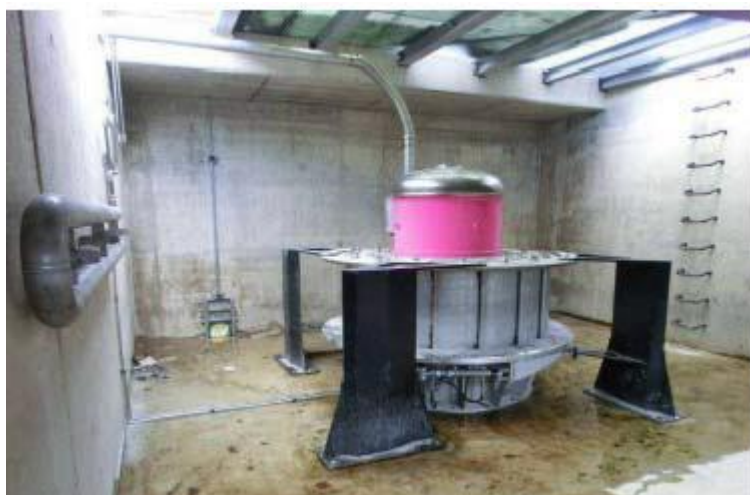
Slika 1.6-2. Izgled ugrađene DIVE turbine.
