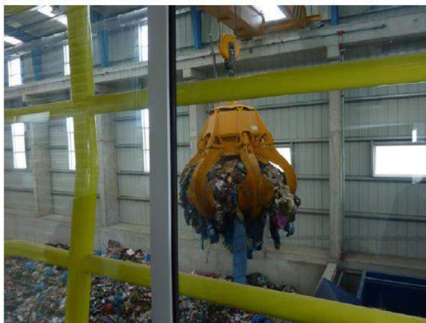
Slika 4.4/2 – Kran za prihvata otpada [1]
