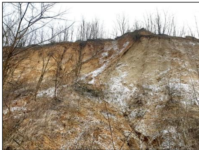
Slika 13. Nesanirana kosina nekadašnjeg iskopa na lokaciji
